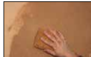
Étape 4 - une fois l'enduit sec, passage d'une éponge semi-humide afin de faire tomber les poussières de surface et faire ressortir la fibre de paille.
